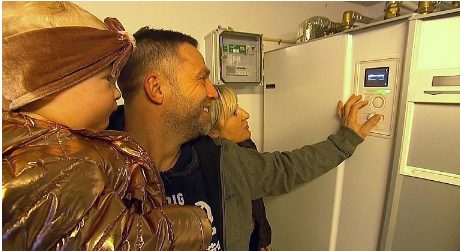
Familien Skovgaard er nogle af de 108 boligejere på Sydhavsøerne, der i løbet af det seneste år har fået skiftet oliefyret ud med en varmepumpe. Foto: TV ØST
