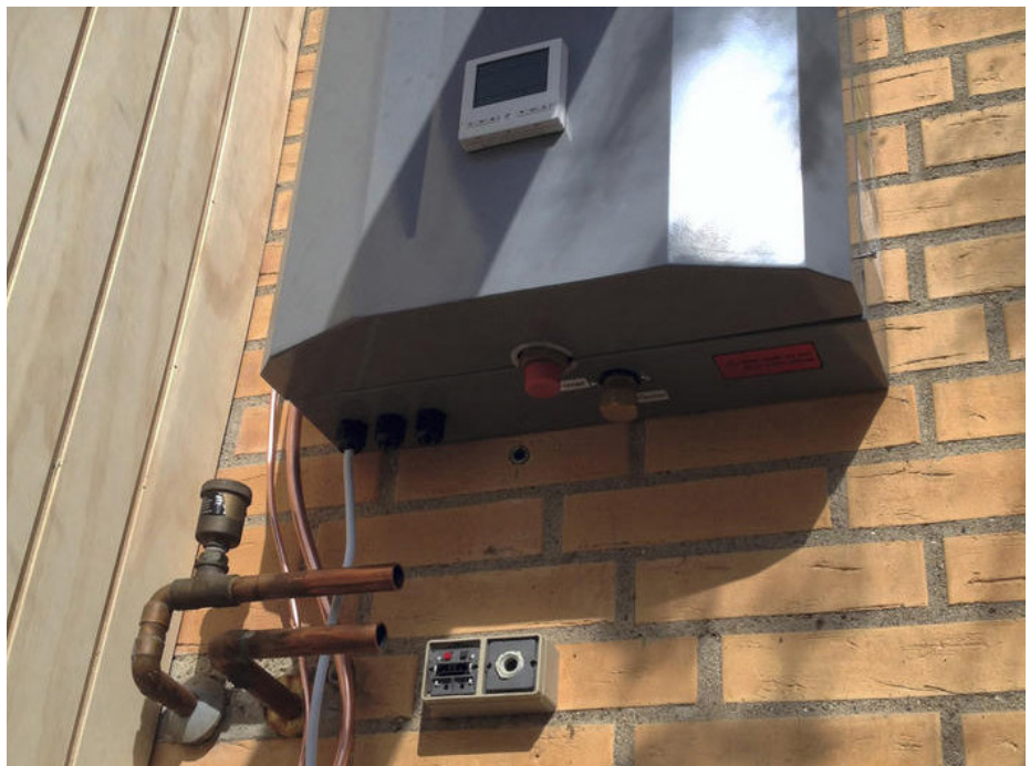
Luft til vand varmepumpeteknologien står til rådighed på leasingbasis fra Best Green og Refa, som Sonny VVS har indledt samarbejde med.
